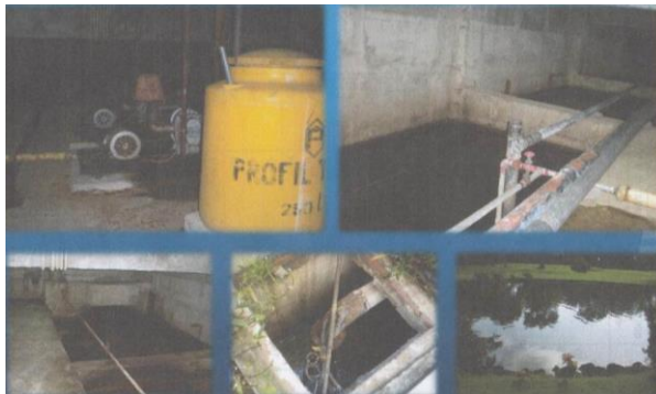
Gambar 17 Instalasi pengolahan air limbah
